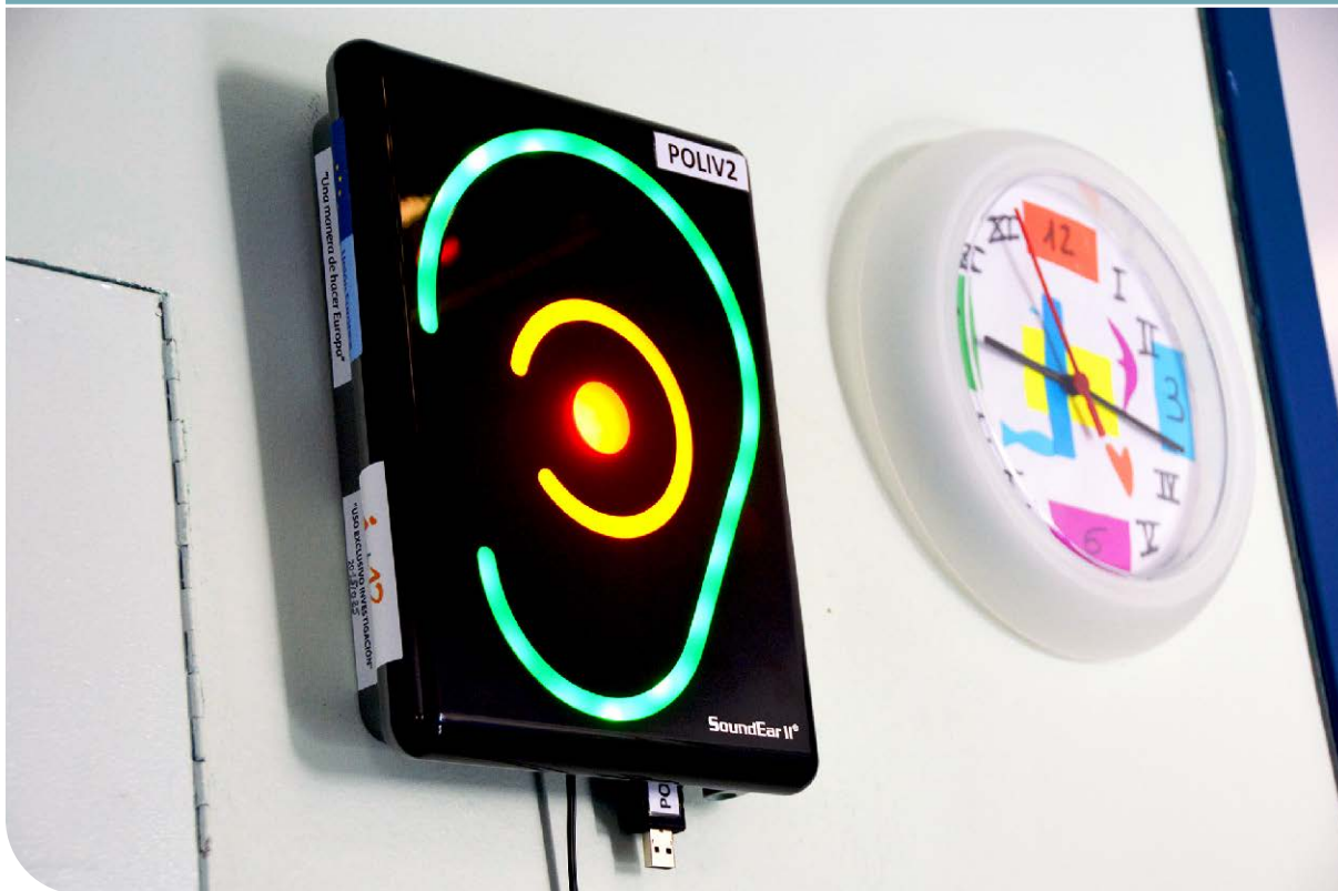
Figura 15. Medidor acústico instalado en una UC 16
